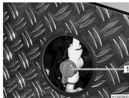
Bilde 134 Tilløpsventil (oppvarming bakre lasteluke)
