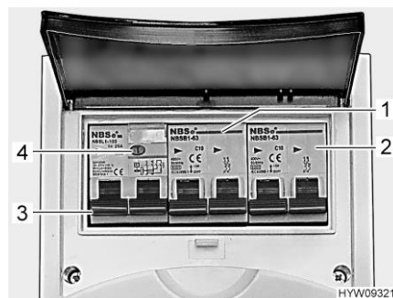
Kuva 111 Johdinsuojakytkimet ja FI-kytkin (230 V:n sulakerasia)
