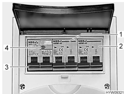
Fig. 101 Disjoncteur de protection de circuit et disjoncteur FI (coffret de fusibles 230 V)
