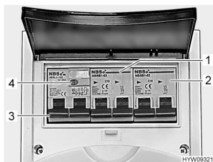
Bild 165 Ledningsskyddsbrytare och FI-brytare (230 V-säkringslåda)
