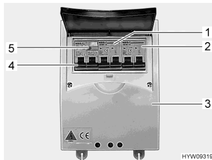
Kuva 150 Johdinsuojakytkimet ja FI-kytkin (230 V:n sulakerasia)
