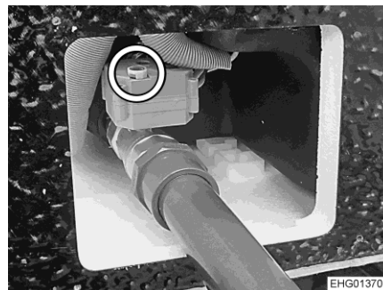
Bilde 151 Håndhjul (spillvannkran)
