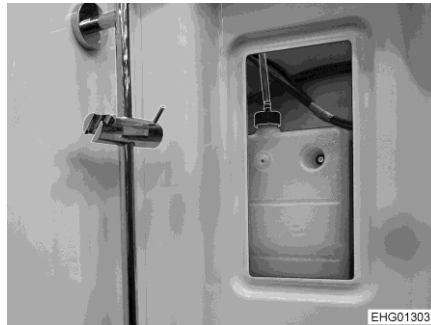
Bilde 164 Ekspansjonstank (varmtvanns-varmeanlegg)
