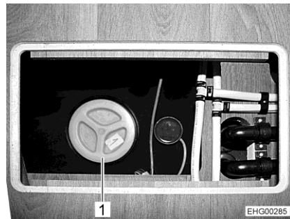
Bilde 117 Rengjøringsåpning (spillvannstank)
