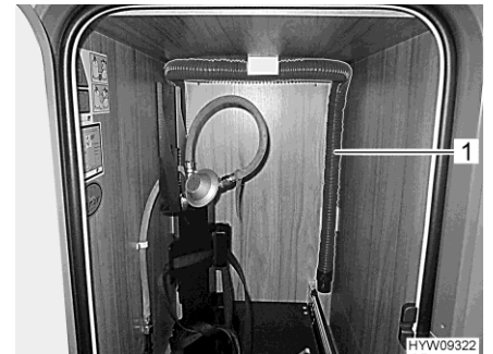
Fig. 130 Manguera de aguas residuales (dispositivo de extracción de caja para bombonas de gas)
