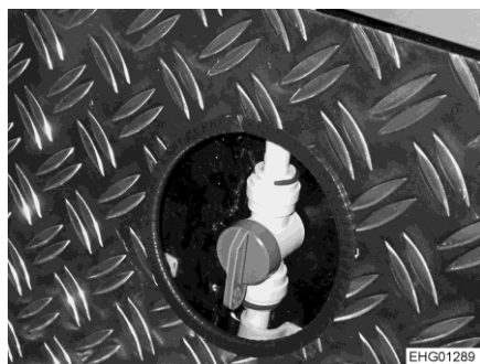
Fig. 183 Valvole di mandata (riscaldamento gavone di coda)
