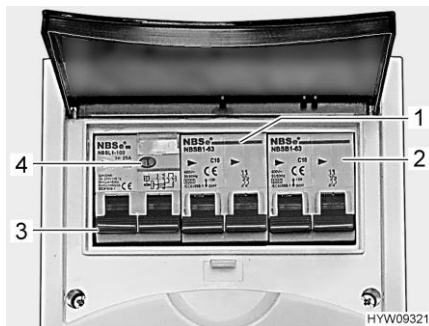
Fig. 147 Interruttore di sicurezza e interruttore automatico FI (scatola dei fusibili a 230 V)
