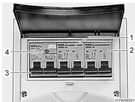
Bild 147 Ledningsskyddsbrytare och FI-brytare (230 V-säkringslåda)
