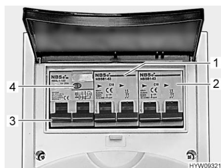
Bild 74 Ledningsskyddsbrytare och FI-brytare (230 V-säkringslåda)
