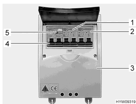
Bild 70 Ledningsskydds-brytare och FI-brytare (230 V-säkringslåda)
