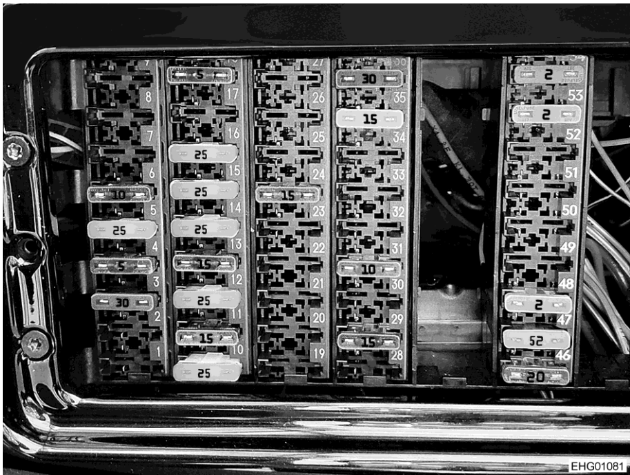
Fig. 79 Fusibles (console du siège conducteur)
