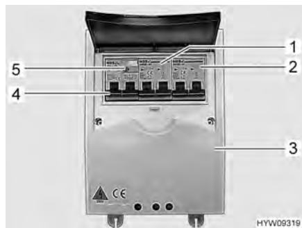
Bilde 65 Ledningsbeskyttelsesbryter og FI-bryter (230 V-sikringsboks)
