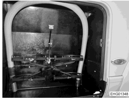
Afb. 208 Afvalwaterslang in de gaskast
