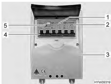
Fig. 66 Interruttore di sicurezza e interruttore automatico FI (scatola dei fusibili a 230 V)
