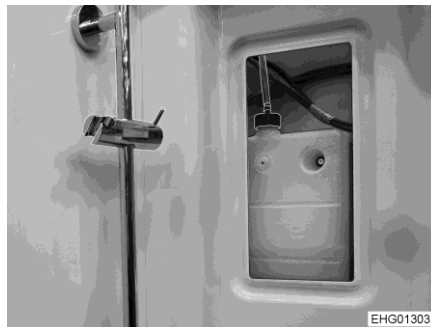
Bilde 222 Ekspansjonstank (varmtvanns-varmeanlegg)
