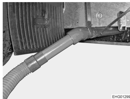
Bilde 207 Avløpsrør med spillvannsslange
