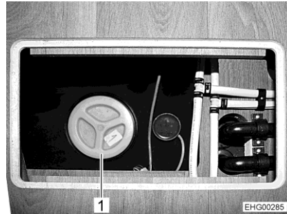
Fig. 117 Apertura per la pulizia (serbatoio delle acque grigie)
