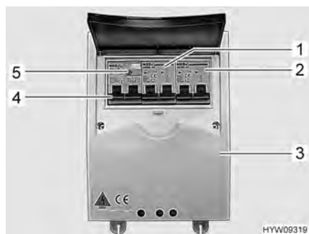
Bild 66 Leitungsschutzschalter und FI-Schalter (230-V-Sicherungskasten)
