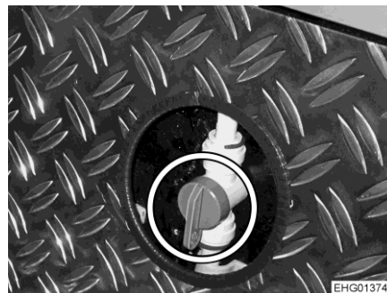
Bild 132 Regelventil (Beheizung Heckstauraum)
