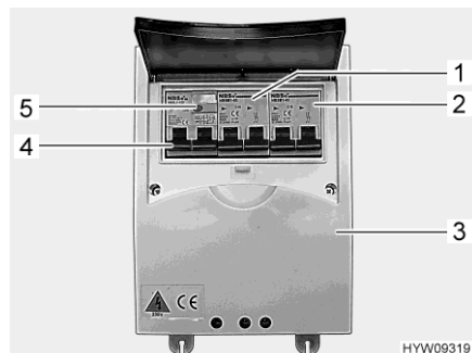
Fig. 96 Interruptor de protección de línea e interruptor FI (caja de fusibles de 230 V)
