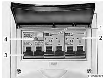
Afb. 70 Beveiligingsautomaat en FI-schakelaar (230-V-zekeringenkast)
