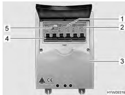
Fig. 66 Disjoncteur de protection de circuit et disjoncteur FI (coffret de fusibles 230 V)
