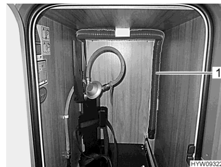
Fig. 130 Tuyau d'évacuation des eaux usées (extension du compartiment à gaz)
