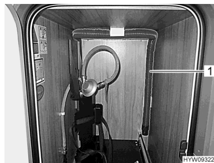
Fig. 147 Manguera de aguas residuales (dispositivo de extracción de caja para bombonas de gas)
