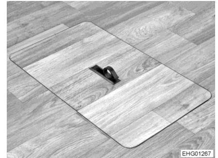
Bild 62 Service-Abdeckung (Griff herausgeschwenkt)
