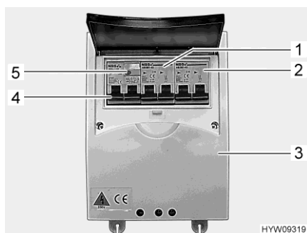
Fig. 152 Interruptor de protección de línea e interruptor FI (caja de fusibles de 230 V)
