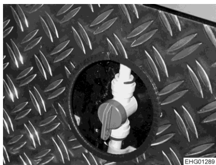
Fig. 183 Valvole di mandata (riscaldamento garage di coda)
