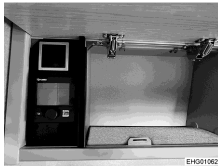
Kuva 83 Yläkaapistossa olevat ohjainlaitteet (esimerkki)
