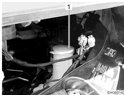
Fig. 37 Tubo de llenado (depósito de agua para lavar)
