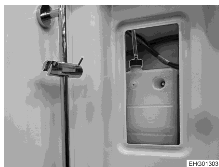
Rys. 222 Zbiornik wyrównawczy (ogrzewanie wody)
