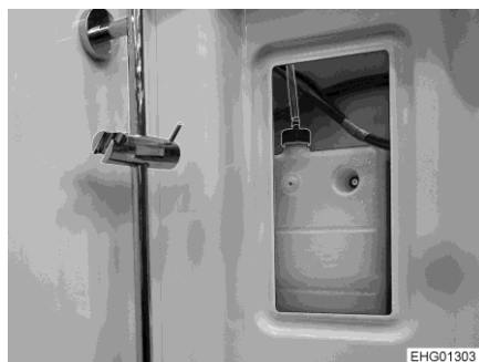
Bilde 222 Ekspansjonstank (varmtvanns-varmeanlegg)
