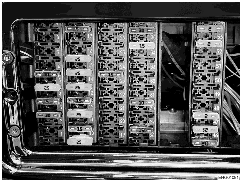
Bilde 79 Sikringer (førerstekonsoll)
