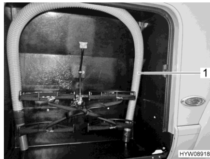
Rys. 214 Wąż odprowadzający ścieki (skrzynia na butle gazowe)
