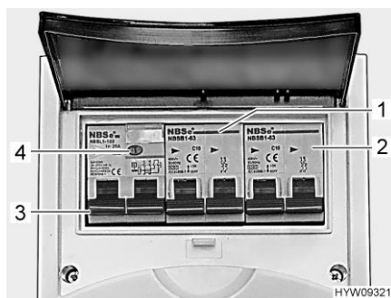
Bilde 74 Ledningsbeskyttelsesbryter og FI-bryter (230 V-sikringsboks)
