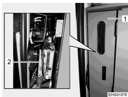
Fig. 72 Lugar de instalación del bloque eléctrico
