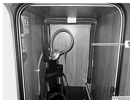
Rys. 160 Wąż odprowadzający ścieki (wyciągnięta skrzynia na butle gazowe)
