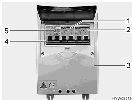
Bild 74 Ledningsskyddsbrytare och FI-brytare (230 V-säkringslåda)
