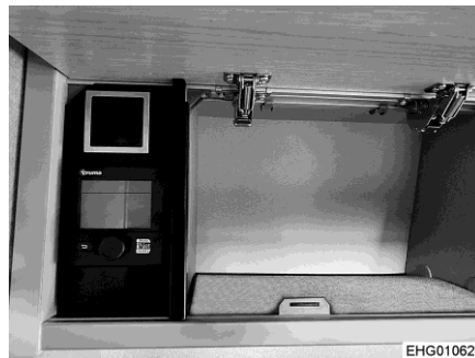
Bild 83 Kontrollenheter i takförvaringsskåpet (exempel)
