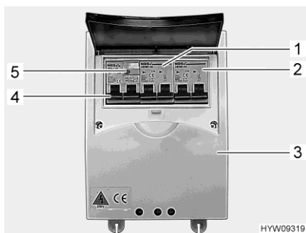
Bilde 150 Ledningsbeskyttelsesbryter og FI-bryter (230 V-sikringsboks)
