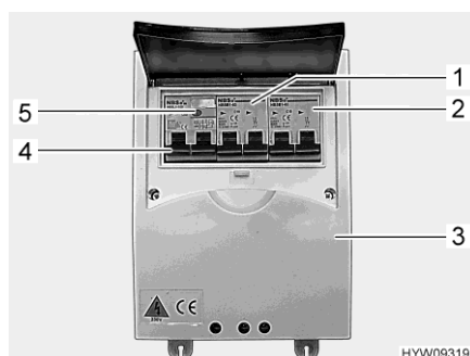
Fig. 97 Disjoncteur de protection de circuit et disjoncteur FI (coffret de fusibles 230 V)
