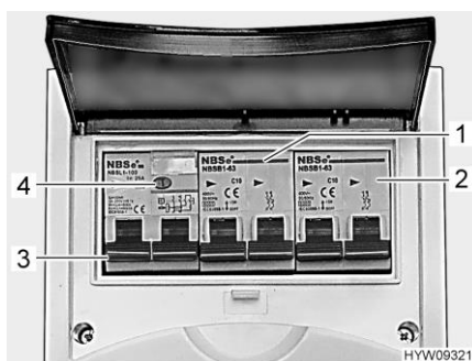
Bild 106 Ledningsskyddsbrytare och FI-brytare (230 V-säkringslåda)
