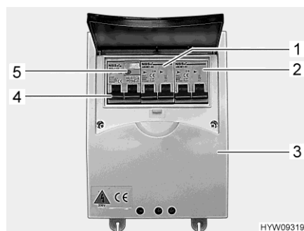
Fig. 134 Interruptor de protección de línea e interruptor FI (caja de fusibles de 230 V)
