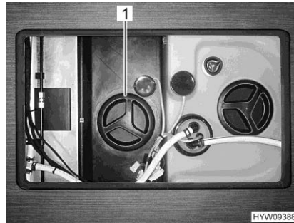
Bilde 209 Rengjøringsåpning (spillvannstank)
