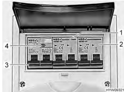
Fig. 70 Interruptor de protección de línea e interruptor FI (caja de fusibles de 230 V)
