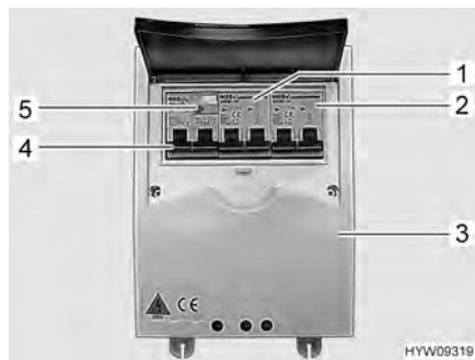
Fig. 66 Interruptor de protección de línea e interruptor FI (caja de fusibles de 230 V)
