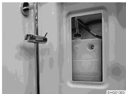
Rys. 164 Zbiornik wyrównawczy (ogrzewanie wody)
