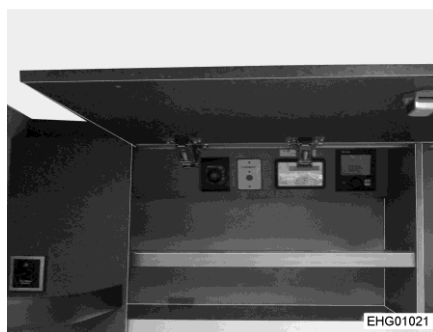
Rys. 117 Urządzenia sterujące w szafce przydachowej
